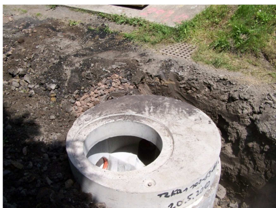
Kanalizační šachta ul. Křivá
